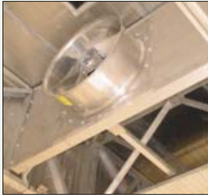
Циркуляция воздуха обеспечивается высокоэффективными реверсивными вентиляторами производства Германии
